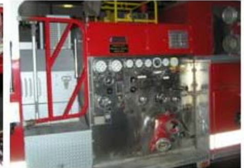
Pump Panel & Generator (overhead)
